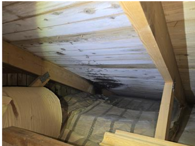
Nockvind: Ytlig mikrobiell påväxt på underlagstak.
