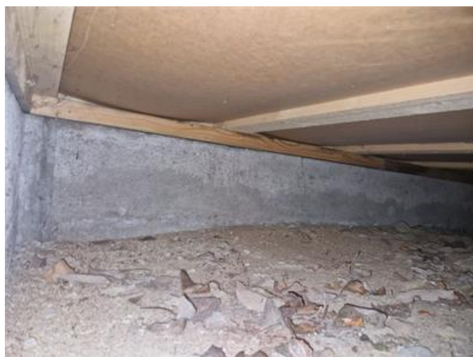
Torpargrund, avdunstningskydd saknas mot mark,
