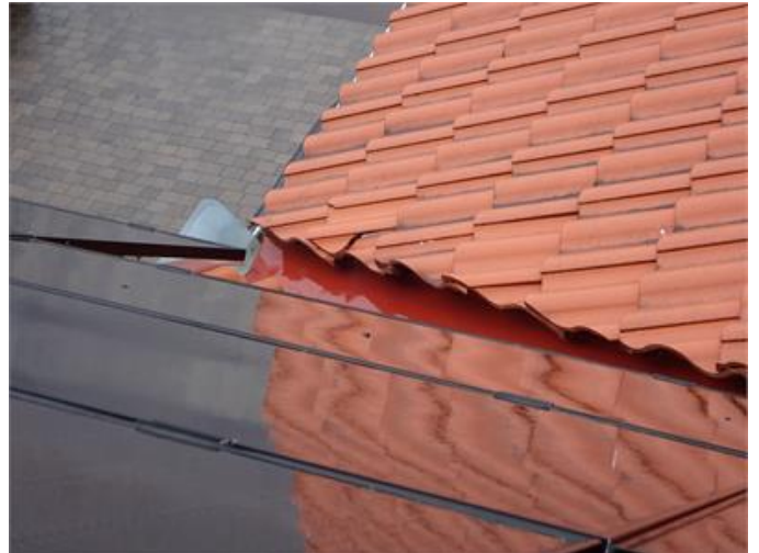
Sprucken takpanna i ränn dal mot farstukvist.
