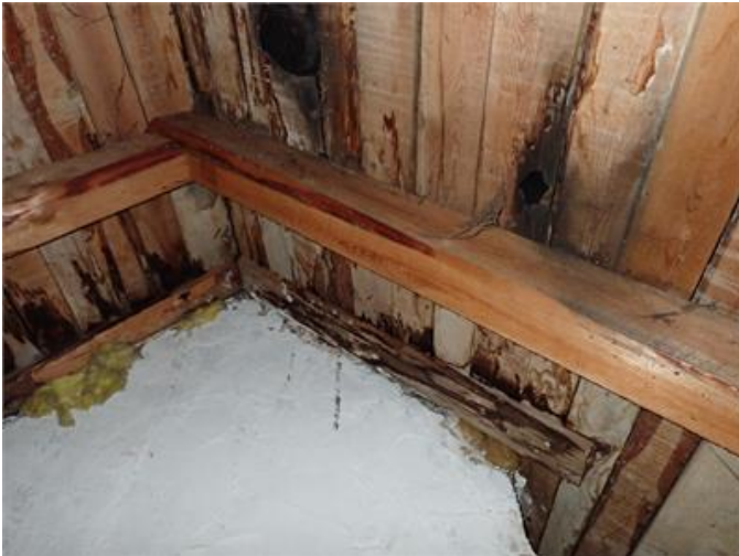
Fuktfläckar på underlagstak vind.
