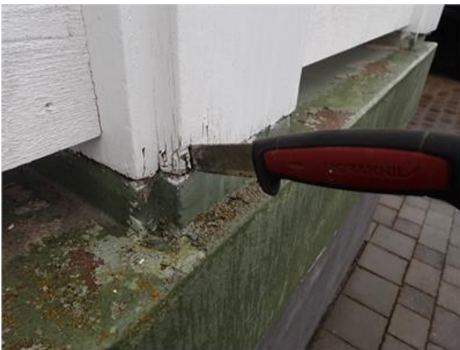
Rötskada i pelare på farstukvist.
