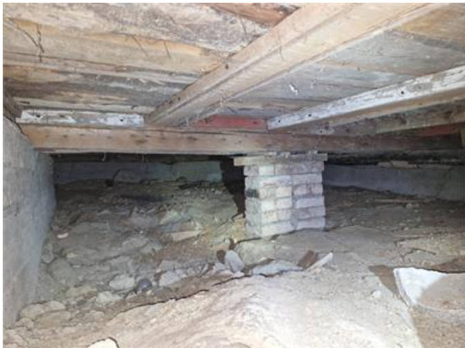
Krypgrund södra delen, äldre träbjälklag, på marken torra lera och en del byggspl.
