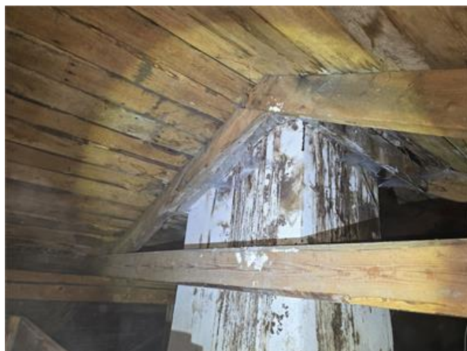
Nockvind, fuktanvisningar och rinnmärken vid och på murstock.
