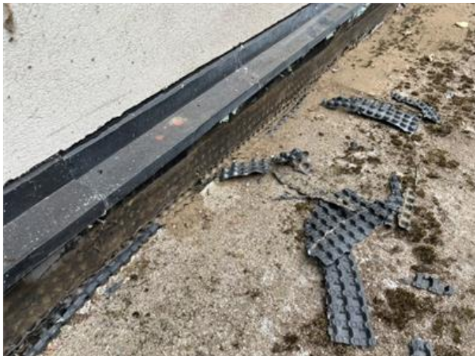
Bilden visar exempel på otätheter/brister vid/med Platonmattan.
