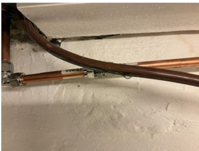
Bilden visar vattenrör där läckage förekommer.
