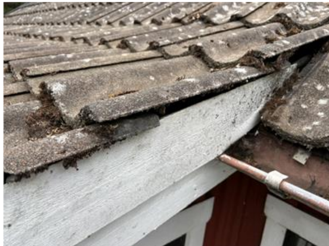
Bilden visar exempel på otätheter/brister i taktäckningen.
