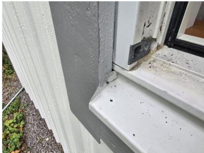
Fönster: Otätheter förekommer mellan karm/foder.
