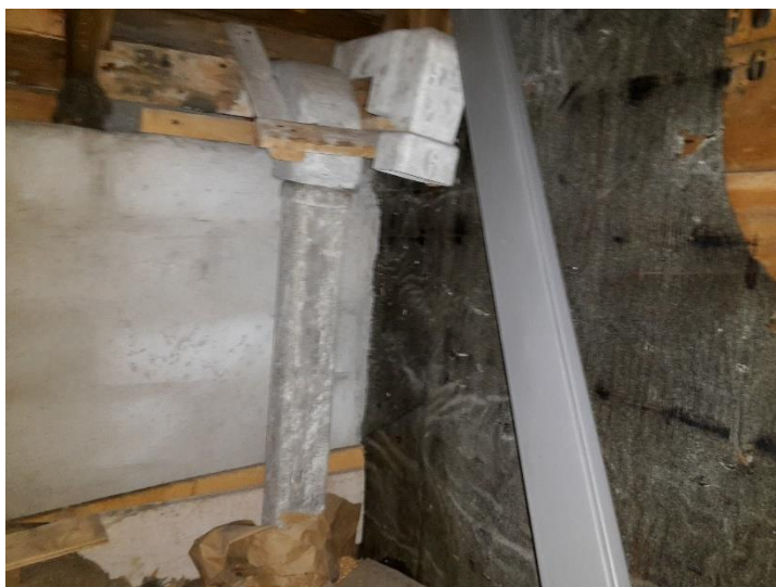
Bild 7: Ventilationskanaler från VC i katt vind innehåller asbest.
