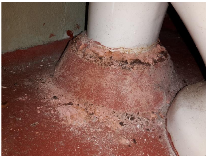
Bild 5: Avloppskitt vid toalettstol innehåller asbest.
