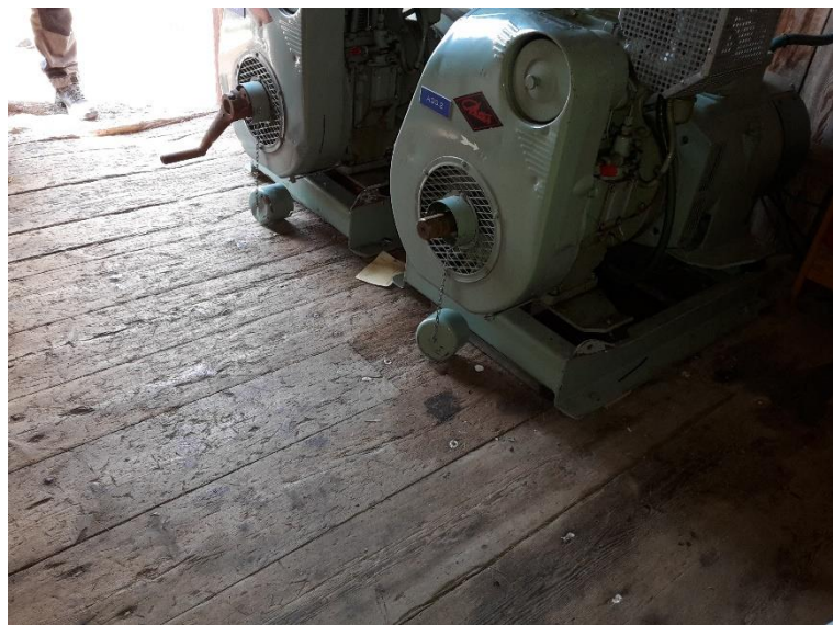
Bild 15: Två luftkylda dieselelverk, ev. spill på trägolv.
