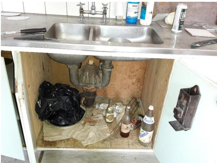
Bild 3: Avloppskitt under diskbänk innehåller asbest i samtliga kök.
