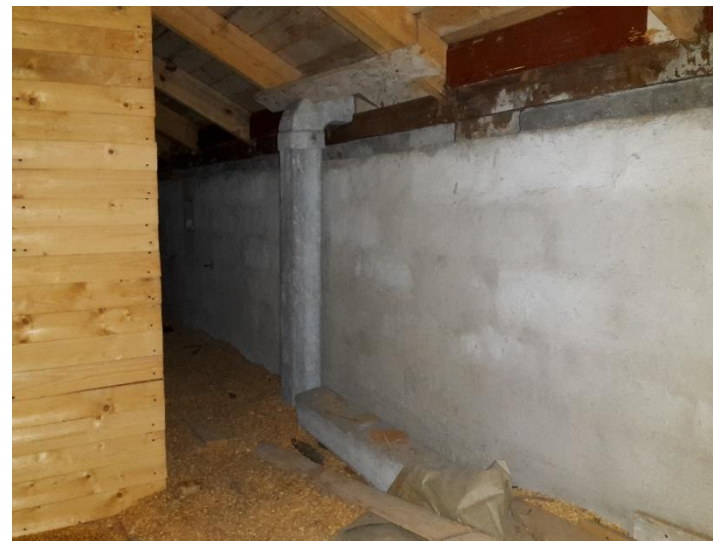
Bild 6: Ventilationskanaler från VC i katt vind innehåller asbest.
