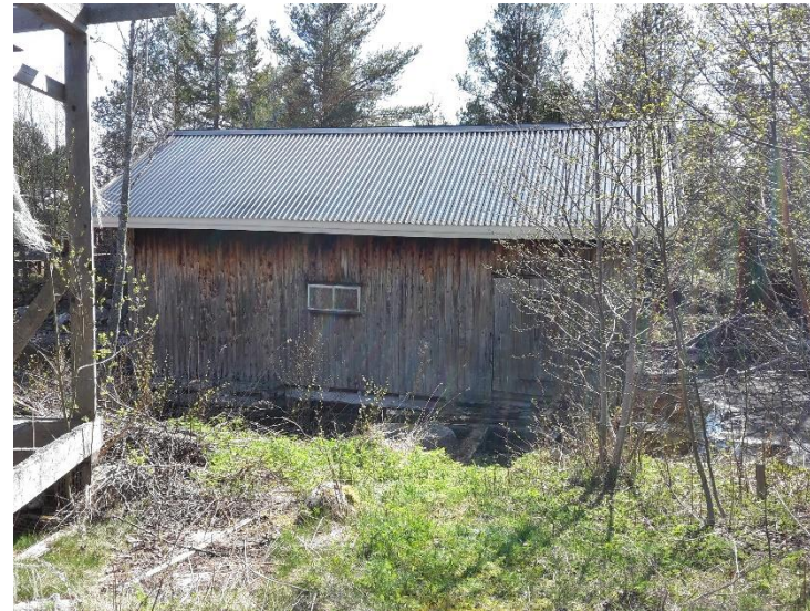
Bild 24: Båhuset. Tjärpapp under plåttaket.
