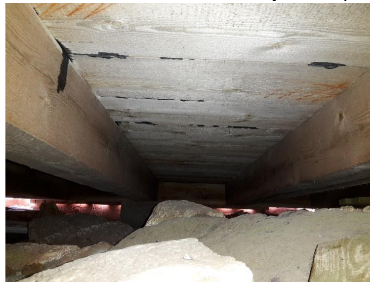
Bild 16: Bild tagen under ev. spill på trägolv, ingen antydning till läckage av förorening till marken under. Golvbrädor torra.
