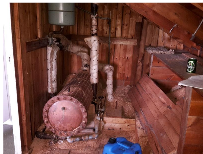
Bild 8: Varmvattenberedare i koppartank innehåller troligtvis asbestpackningar.
