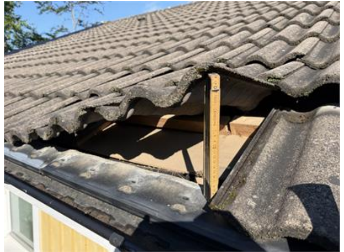
Underlagstaket består av plywoodskivor och de nedre takpannorna är inte fastmonterade.
