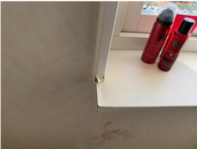
Fönstersmygen i dusch/wc är fuktpåverkad i nederkant, våtutrymmet börjar komma upp i ålder.
