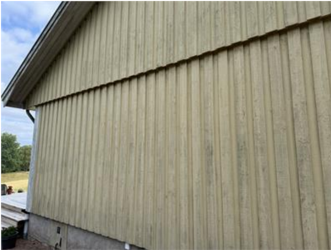
Fasaden är i behov av tvättning och målning.
