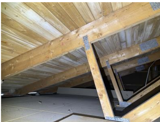
Nockvind: Mikrobiell påväxt noteras på underlagstaket.
