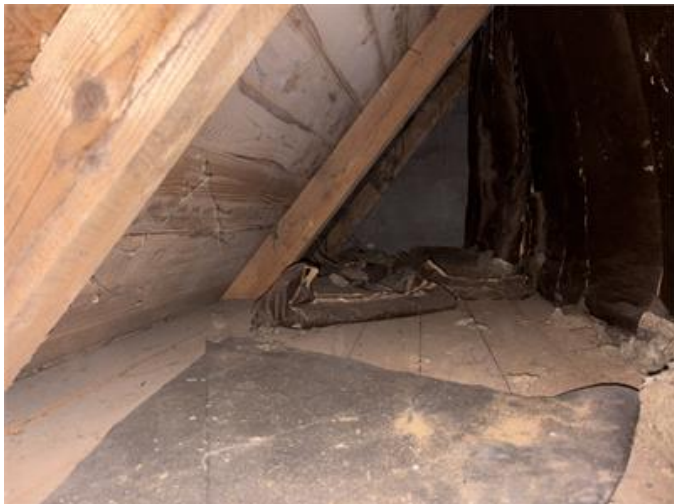
Bild tagen i sidovind, ingen förhöjd fukt uppmättes i takkonstruktionen vid besiktningen.
