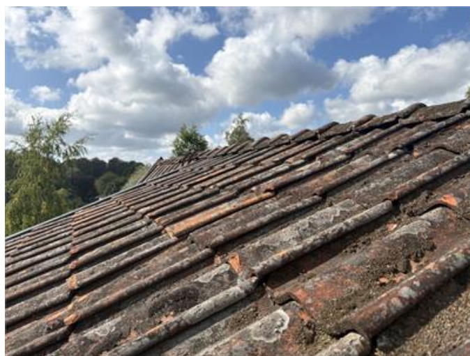
Frostsprängning tegelpannor kupa.
