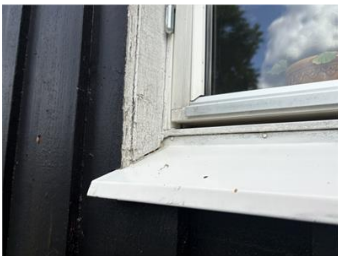
Fönsterbleck utan uppvik.
