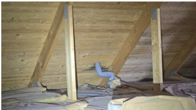
Exempelbild, fuktfläck i underlagstak, vind.
