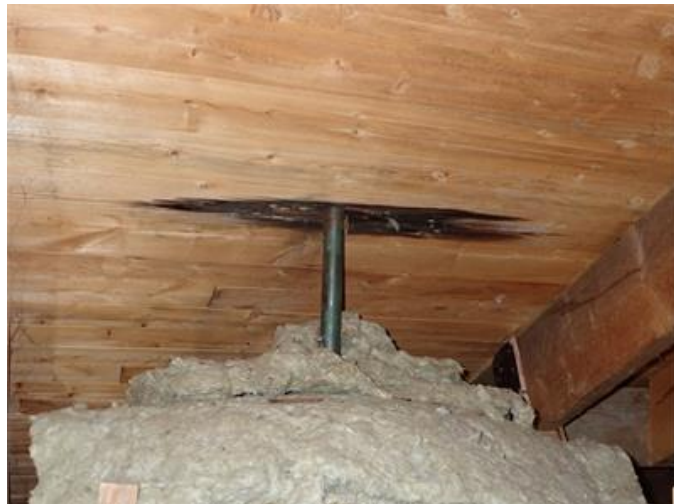
Fuktpåverkan på underlagstak vind vid genomföring.
