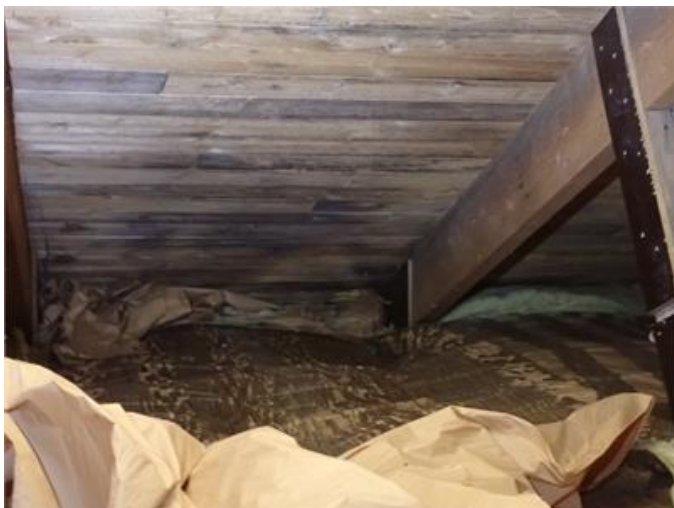
Exempel på mikrobiell påväxt på underlagstak vind.
