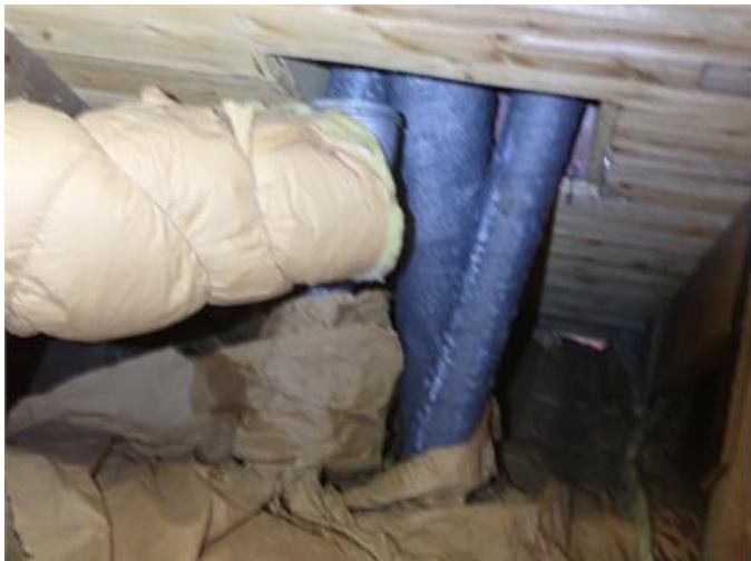
Ventilationstrumma som är oisolerad samt avslutar i vindsutrymmet.
