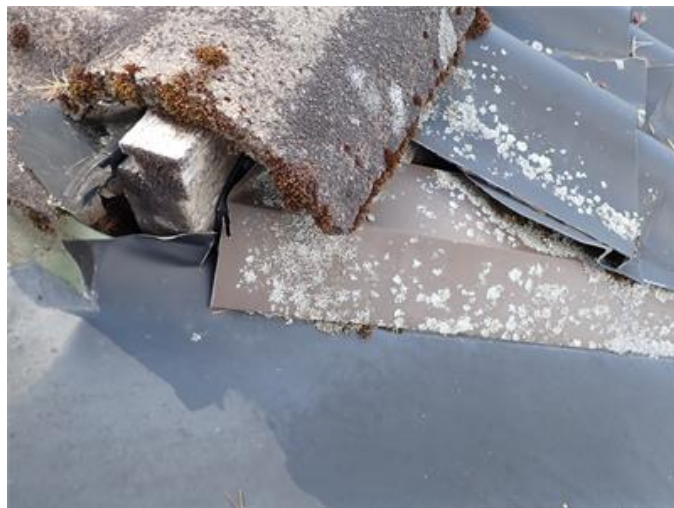
Otätthet mellan mot plåttaket.
