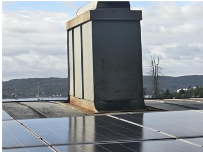
Tak: Rostanvisningar på skorsten.
