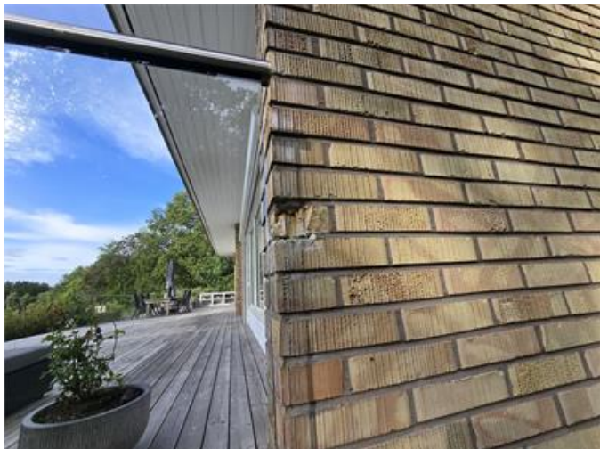
Fasad Tegel: Frostsprängt tegel noteras lokalt.
