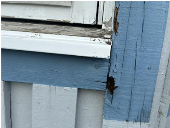
Fasad: Exempel på rötskador i fasadpanel samt underhållsbehov fönster på burspråk kök.
