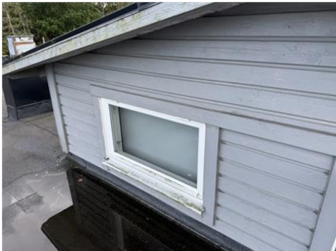
Exempel fönster där överbleck saknas
