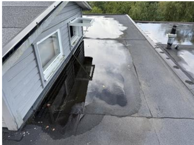
Exempel svackor/lågpunkter på tak med ståendes vatten
