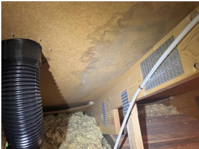
Bild visar fuktfläck på underlagstaket på vinden.
