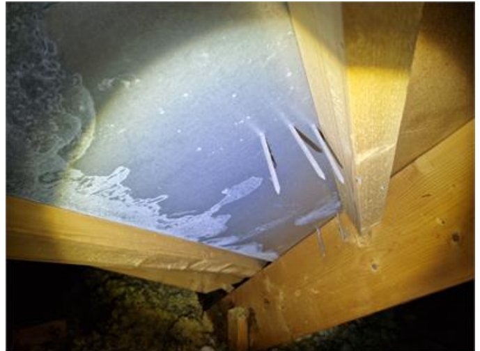
Nockvind: Spikar noterades i rännslåtarernas undersida.
