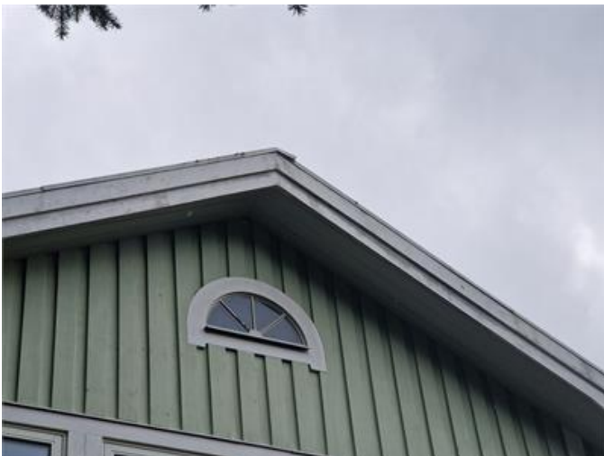
Tak: Kantplåtar/vattplåtar har delvis behov av justering
