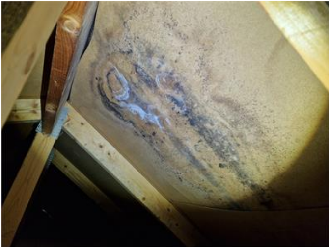
Nockvind: Påväxt och missfärgningar noterades lokalt i större omfattning.
