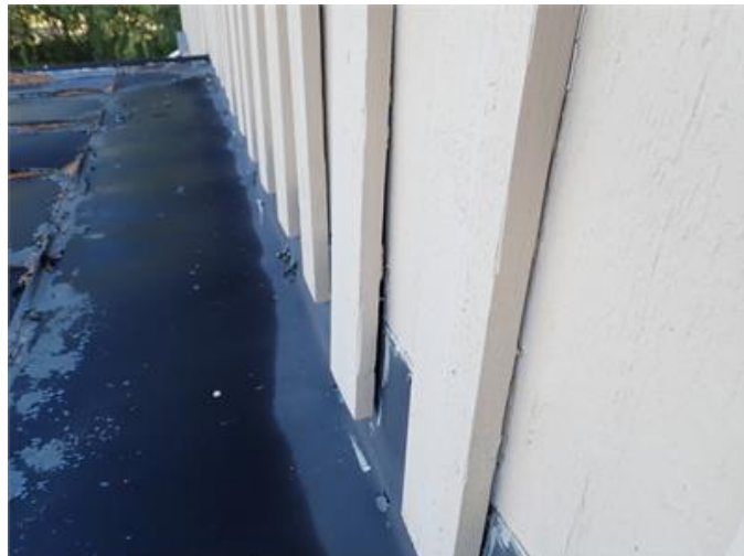
Exempel på otätet mellan lock och fasadpanel.
