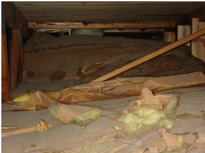
Fuktpåverkan vid ventilationstrumma på vinden.
