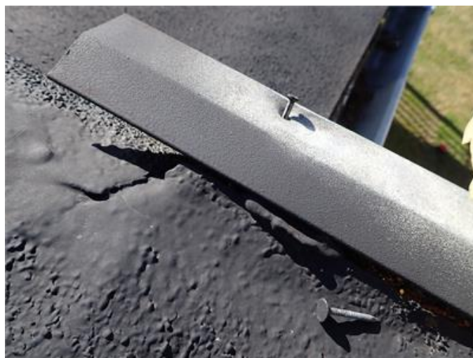
Vindskiveplåt som släppt i infästning.
