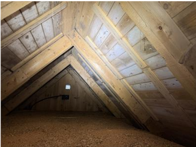
Översiktsbild vindsutrymme, mikrobiell påväxt på underlagstak
