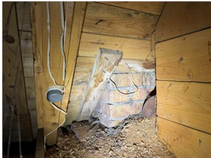
Exempel på fuktfläckar/missfärgningar i underlagstak på vind
