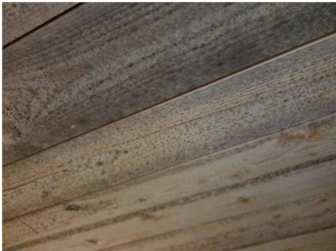
Mikrobiell påväxt på underlagstak (Vinden)
