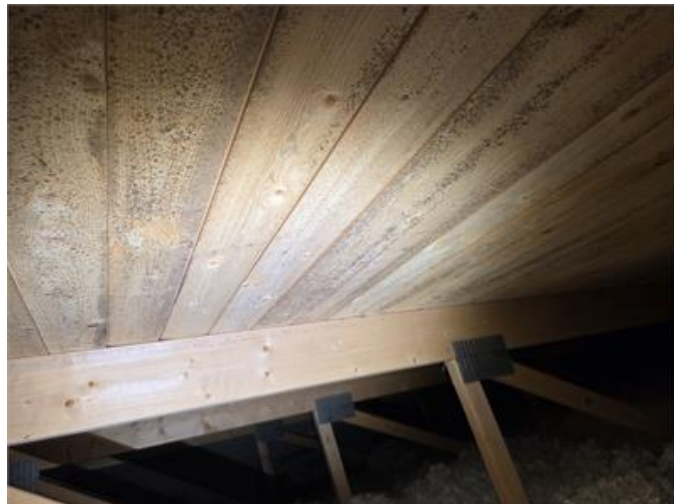
Mikrobiell påväxt på underlagstak (Vinden)
