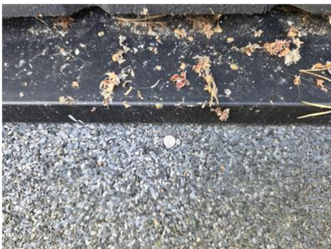
Synliga spik på kallförrådets tak.
