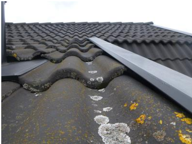
Kort överlapp mellan pannor och vindplåt på takkupa
