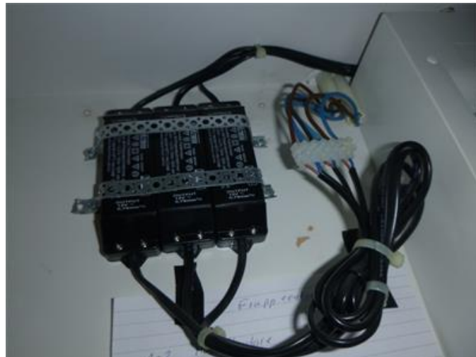
Oisolerade fk kablar vid elcentral samt transformatorer uppsatta med hålbånd i metall
