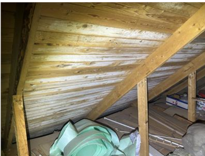
Nockvind: Mikrobiell påväxt noteras på underlagstaket.
