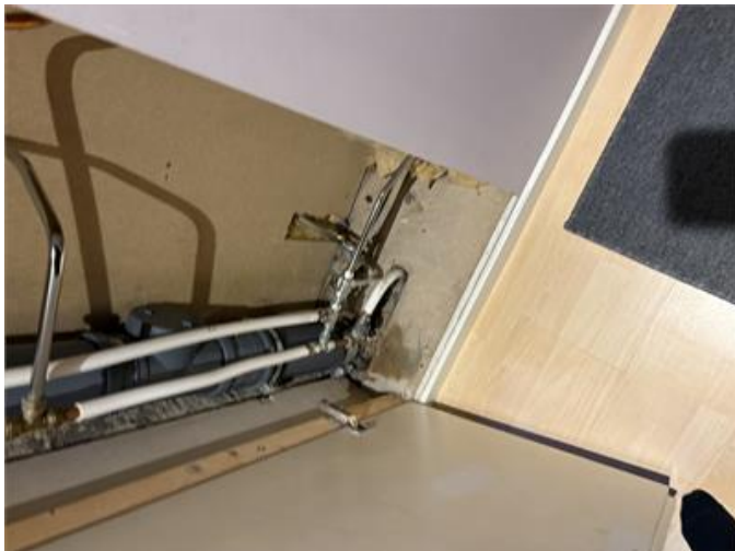
Svale: Tätskikt saknas i utrymme för vatteninstallationer
