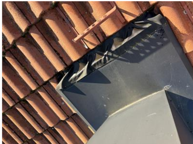
Tak: Skorstenstätning har delvis släppt och bör justeras
