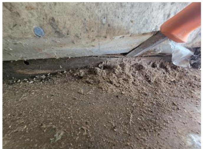
Garage: Rötskadad syll.
