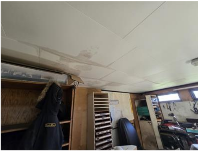
Garage: Fuktskada i innertak.
