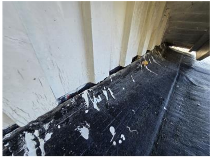
Garage: Otätheter noteras vid uppvik mot fasad.
