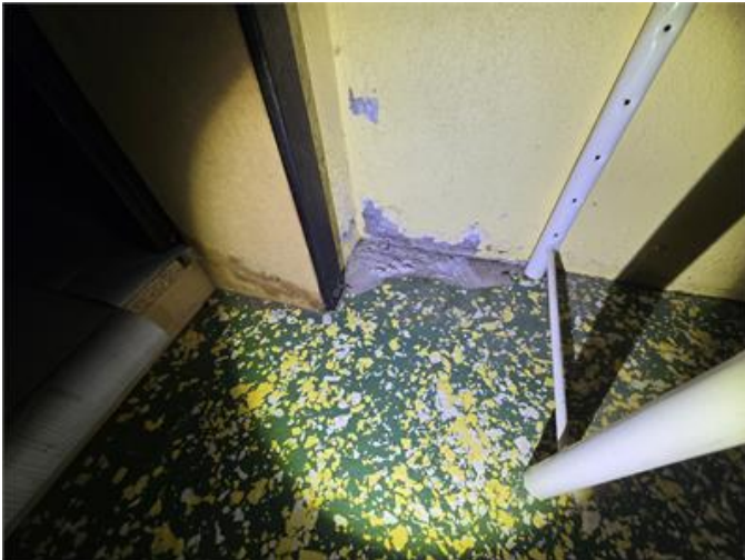
Källare: Exempelbild på fuktanvisningar/färgsläpp.
