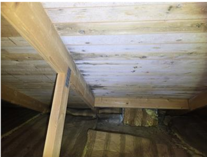
Nockvind: Mikrobiell påväxt på underlagstak.
