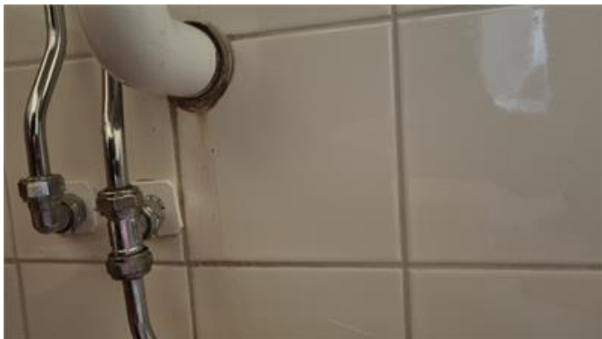
Rinnmärken under skarv, avloppsrör, wc entréplan.
