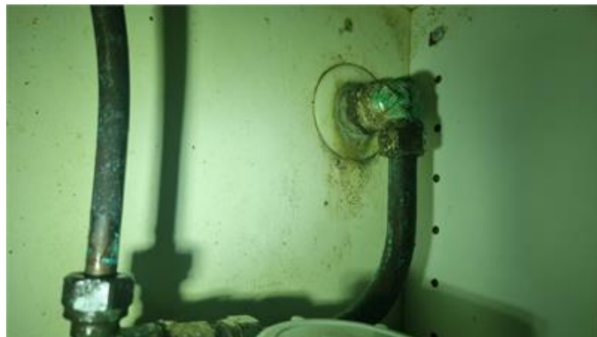
Misstänkt läckage och kondens på vattenrör och kopplingar i diskbänksskåpet.
