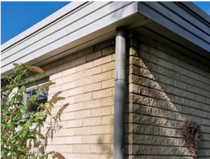
Garage: Missfärgningar förekommer på tegelfasad och fuktfäckar med förhöjda fuktvärden förekommer på insida garagevägg.
