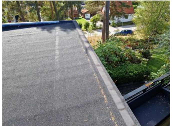
Tak: Takpapp har delvis lagt ovanpå kantplåtar.
