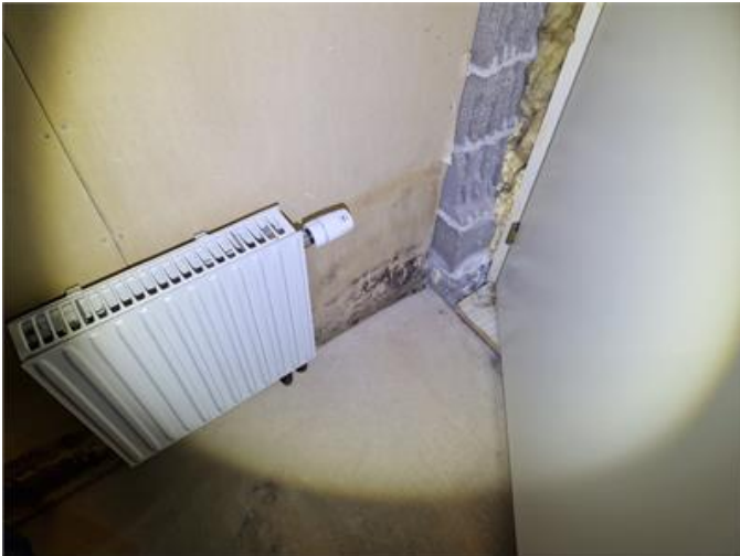
Källarplan/Förråd: Missfärgningar/påväxt noterades i nederdel av vägg.
