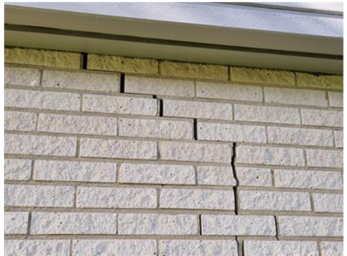
Garage: Genomgående sprickor noterades i garagevägg.
