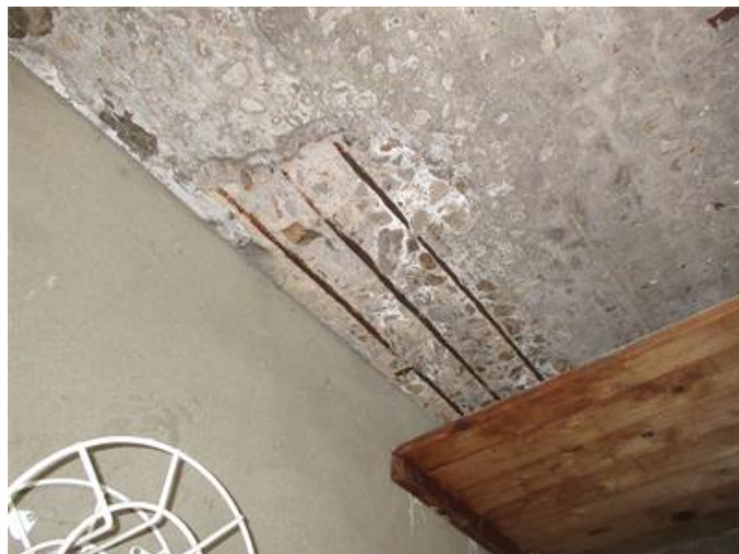
Frostsprängningar i betongtak under stenaltan
