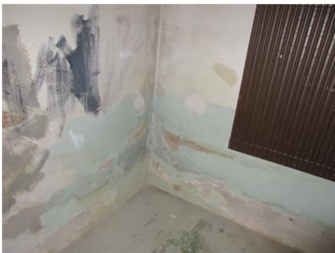
Exempel på putssläpp på väggar i källare
