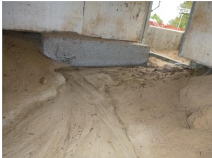
Spår av läckande vatten kring grundens lucka ner i krypgrunden
