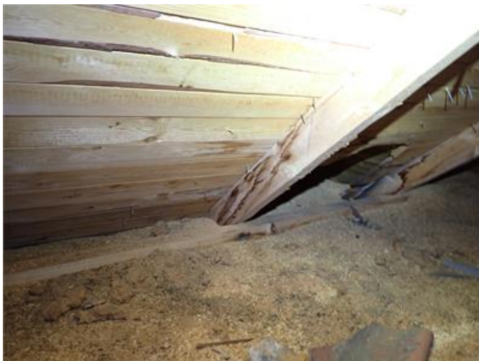
Exempel på fuktfläck på underlagstak vind.
