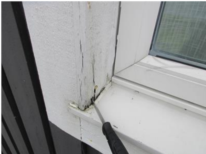
Bild visar röta i fönsterfoder.
