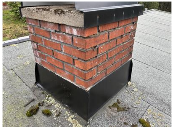
Skorsten: Fogsläpp finns på skorsten.
