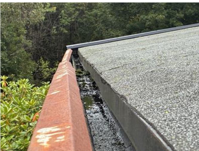
Tak: Hängränna har lågpunkt där sargen har fått skador.
