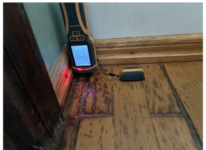
Vardagsrum: Bilden visar missfärgningar i vardagsrum vid yttervägg/fönster.
