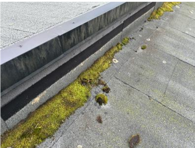
Tak: Bilden visar uppvik av papp på vägg som börjar släppa.
