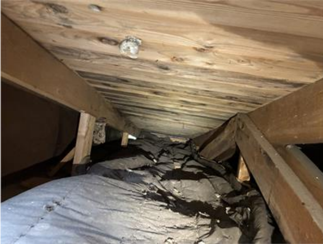
Nockvind: Bilden visar missfärgningar på underlagstaket.
