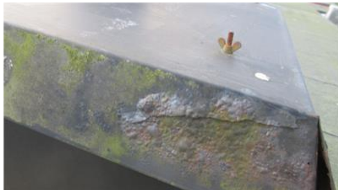
Rostskadad huv på tak.
