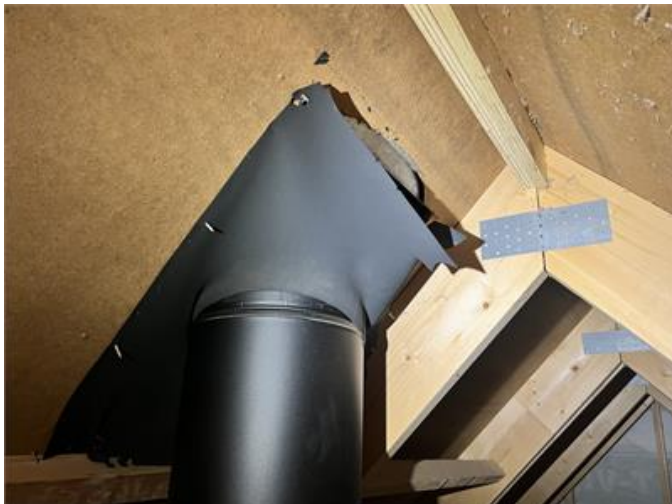
Duk runt skorstenen som släppt vid infästning tak.
