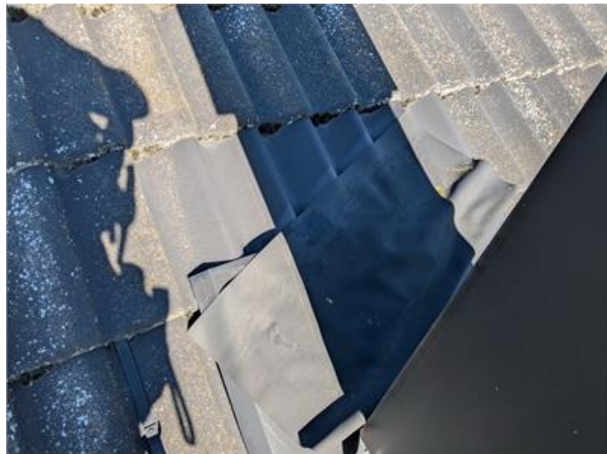
Gummidukstättning vid skorstensbeslag i olag.
