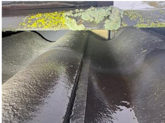
Bilden visar skorsten där otätheter/brister förekommer/underbeslag saknas.
