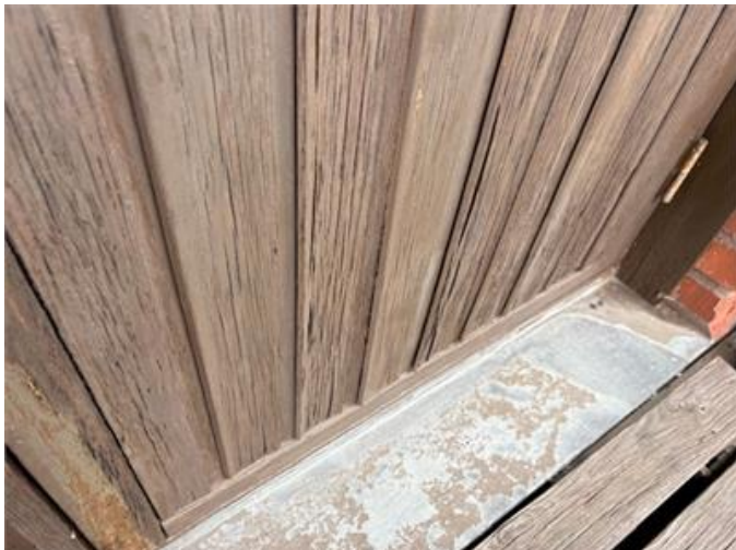
Bilden visar exempel på dörr där torrsprickor/formförändringar förekommer.
