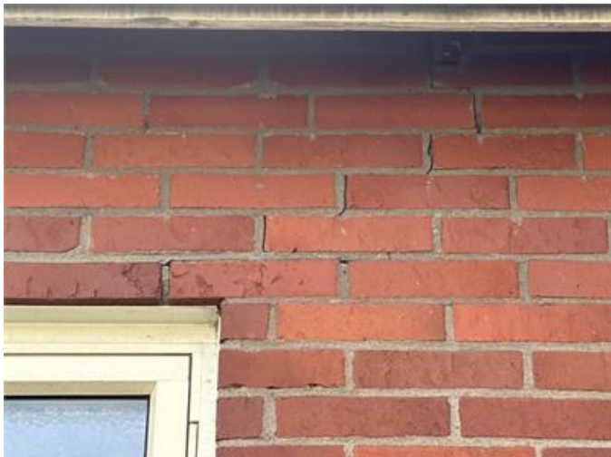
Fasad: Bilden visar sprickbildning i fasad.
