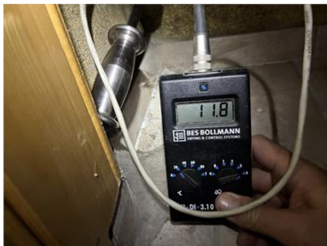
Fuktkvotsmätning i påreglad vägg under trappa i källare, gränsvärde 17%FK.
