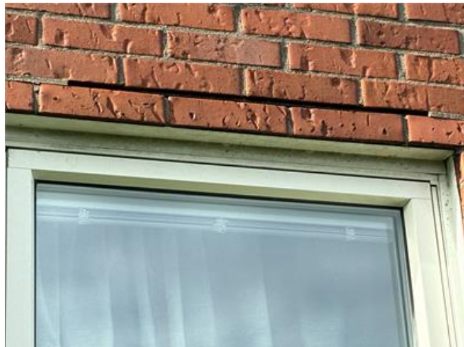
Fasad: Lösa tegelstenar / lös fog över fönster.
