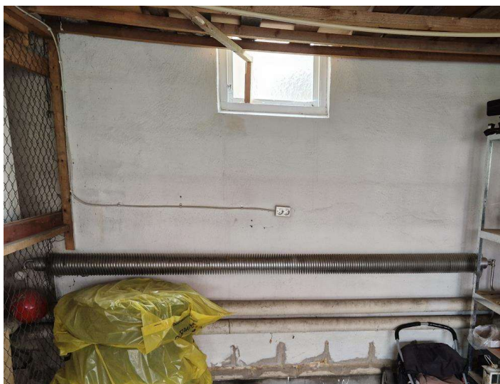
Figur 7 Värmeväxlare i fastighetens garage
