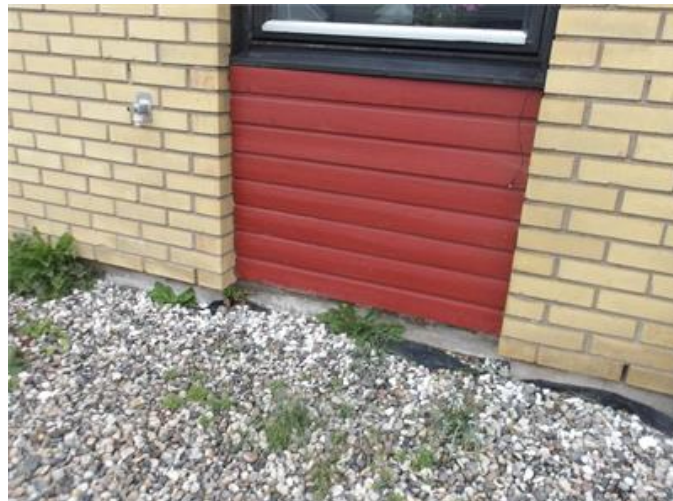
Fasad: Det finns otätheter mellan beklädnadsbrädor och tegelfasad samt mot sockeln under fönsterpartier. Det rekommenderas att tätning utförs.
