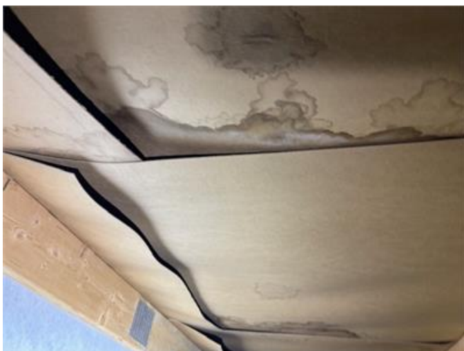
Bilden visar exempel på missfärgningar i underlagstaket.
