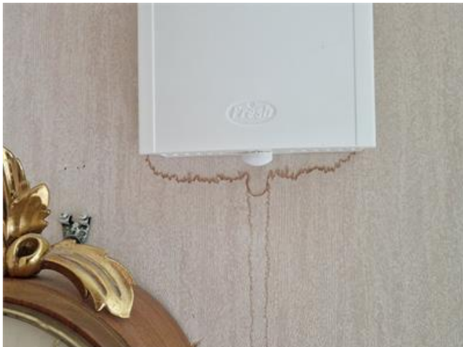
Sovrum 2: Fuktmärken förekommer på vägg vid friskluftsventil.
