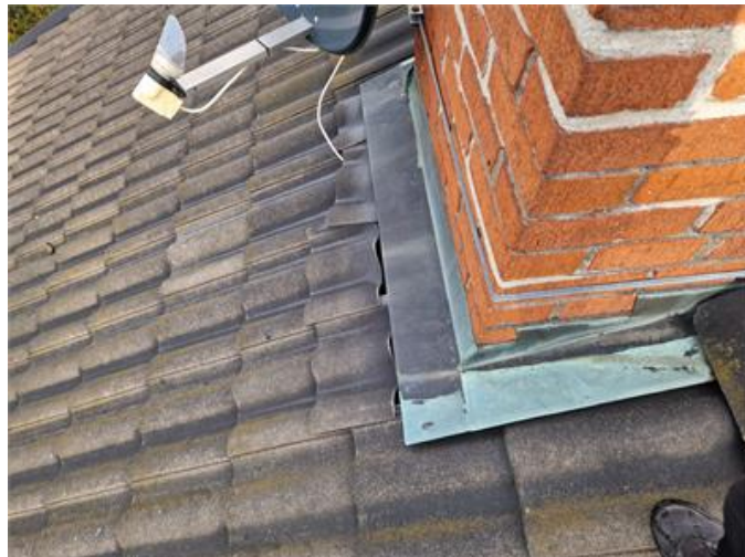
Tak: Takpannor invid skorsten har behov av justering
