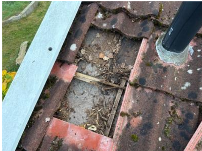
Bilden visar exempel på brister i taktäckningen.
