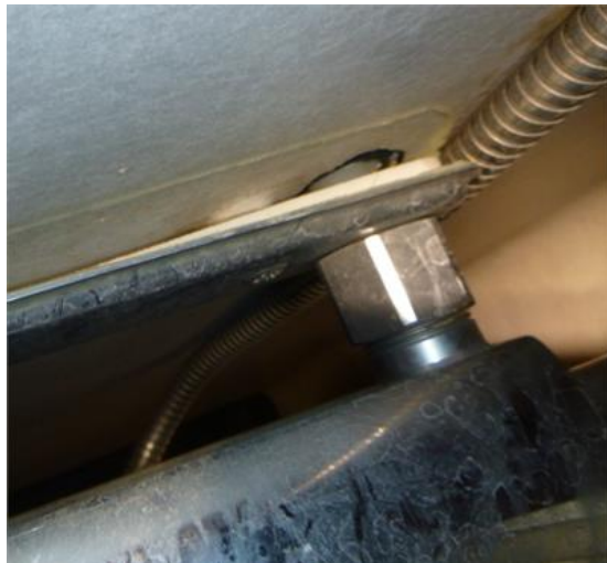
Otät infästning av duschblandare i vägg på entréplanet
