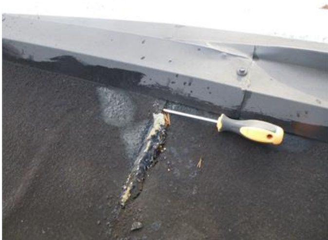
Släppande väder tillfälligt tätade på garage/förrådstaket
