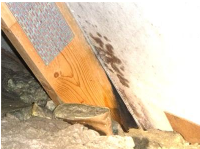
Mindre missfärgning på insida yttertak på vindsutrymme efter luftläckage från bostaden
