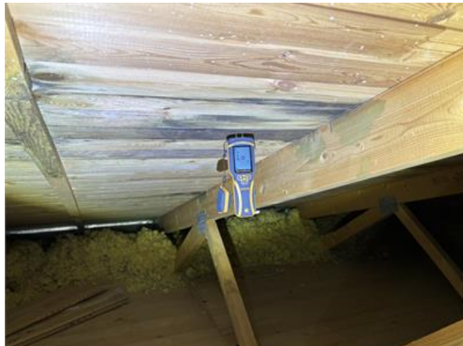
Bild visar fuktfläck på vind
