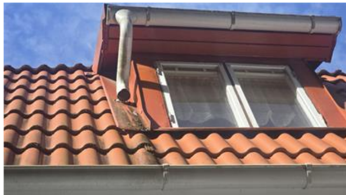
Exempelbild, otätheter mellan äldre plåtarbeten/takpannor.
