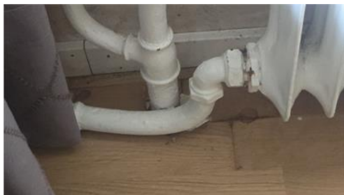
Exempelbild, fuktfläckar i golv under radiatorrör/kopplingar.
