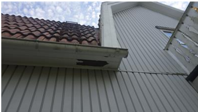
Område i takfot med misstänkt fuktskada.
