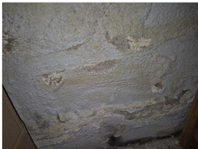
Putssläpp och hög fukt på källarvägg.
