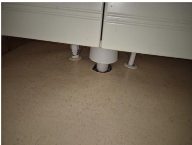
Spår av fuktskada i golv under handfat, övre plan.
