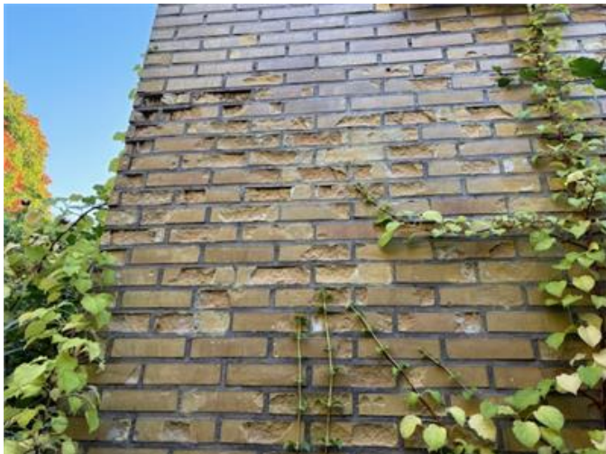
Bilden visar exempel på frostsprängningar i tegelfasaden.
