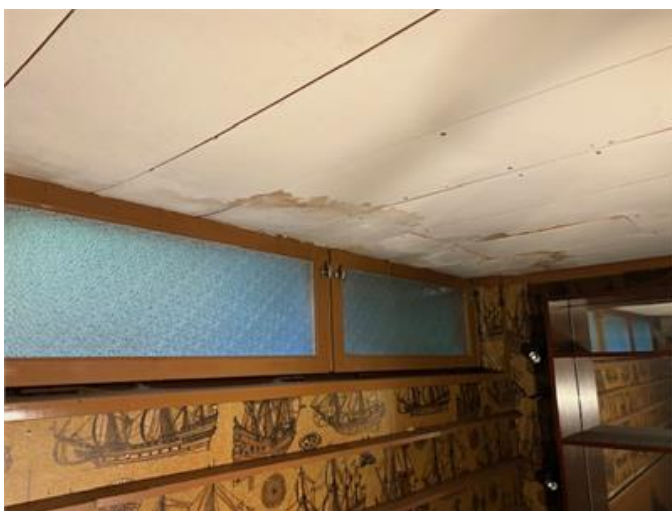
Bilden visar exempel på missfärgningar/formförändringar i tak (källaren).
