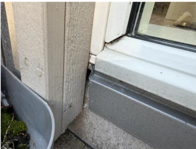
Exempel på bristfälliga plåtdetaljer invid fönster/dörrar.
