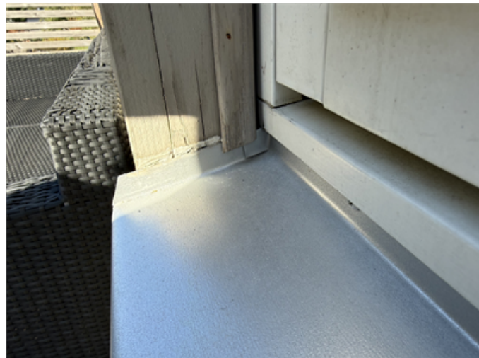
Exempel på otäthet mellan fönster och fasad och bristfälliga plåtdetaljer.
