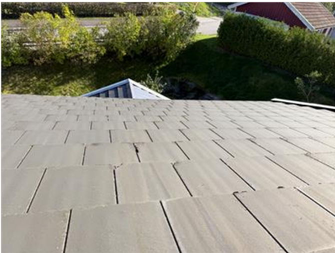
Exempel på takpannor med sprickor/spruckna hörn.
