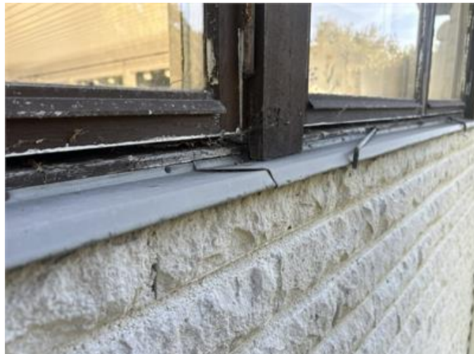
Fönsterbleck: Bakfall noteras på tex norrsidan.
