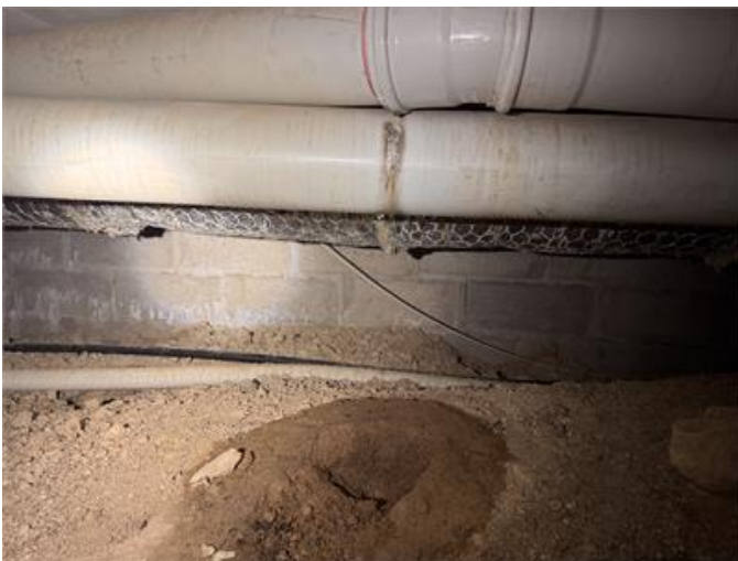
Skarv på avloppsledning håller inte tätt.
