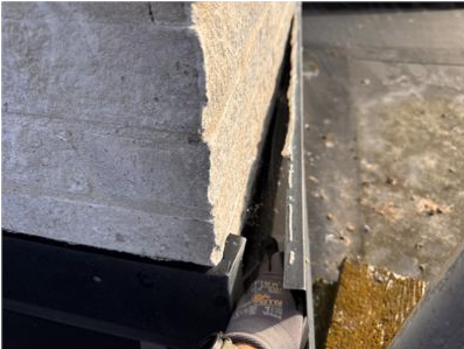
Plåtbeslag runt skorsten glipar.
