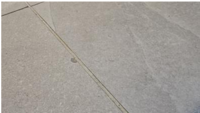
Exempelbild, "flisa" som släppt från en klinkerplatta.
